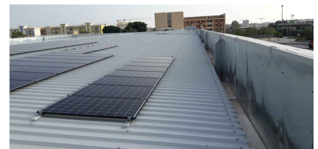
pannelli fotovoltaici potenza 39 kWp
